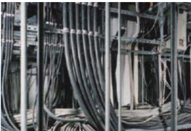
电缆布线复杂，火灾荷载高
